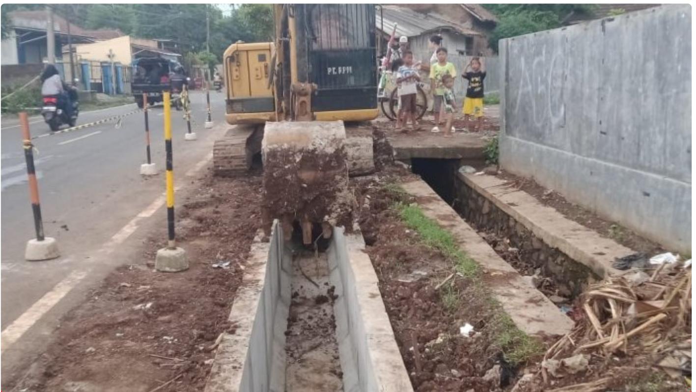
Proyek Drainase Jalan Pandeglang - Labuan Diduga Tak Sesuai Spesifikasi Kontruksi
